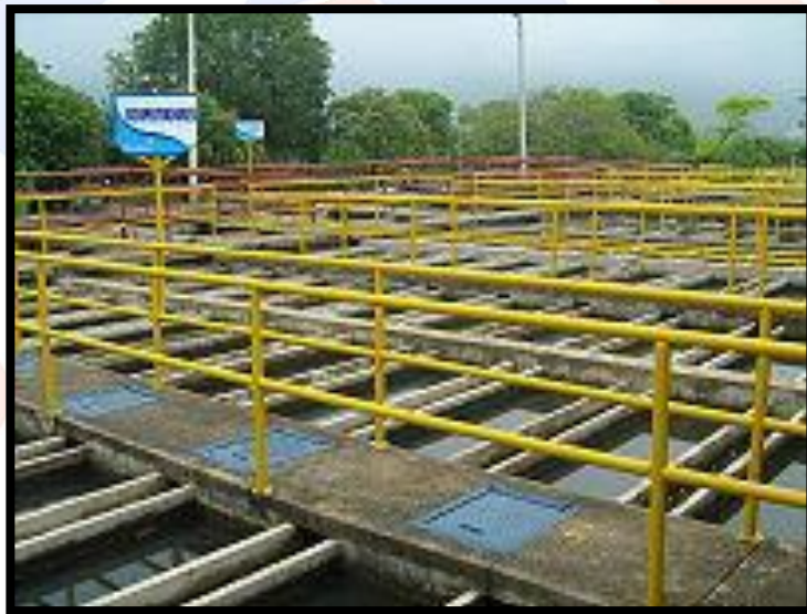
Planta de tratamiento de agua potable de Valledupar.
