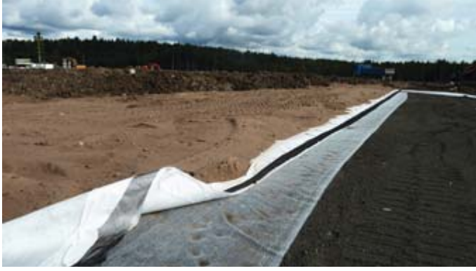
Rakennekerrosten asentamista vuonna 2011. Pohjatuhkan päälle asennettiin bentoniitti- ja salaojamatot, joiden päälle levitettiin suojahiekka- ja peittokerros.
