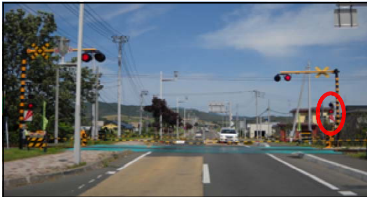
(全方向踏切警報灯【踏切全体像】)
