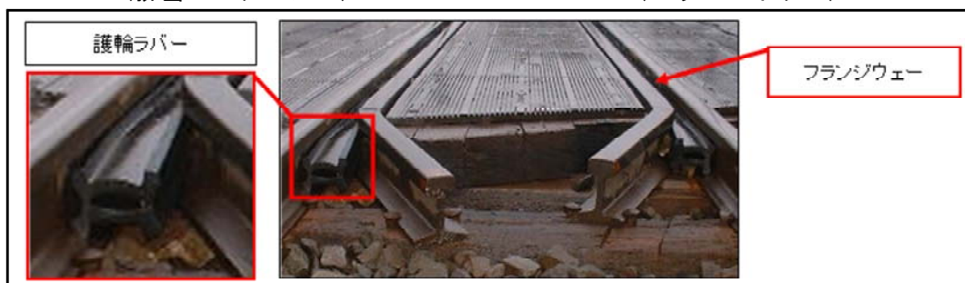
(踏切に設置された護輪ラバー)
