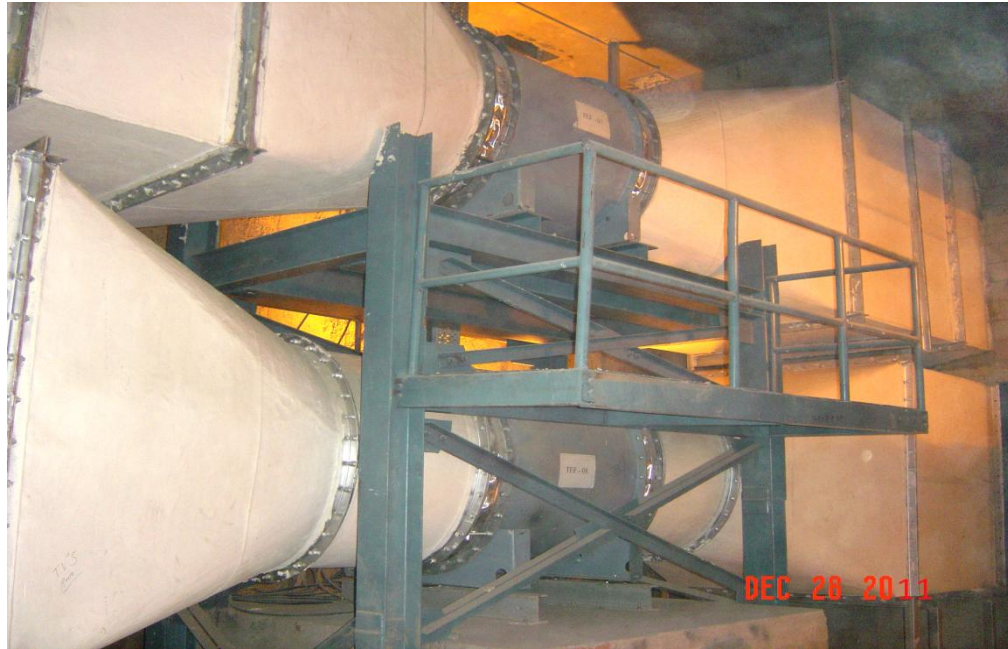
Trackway Exhaust Fan
