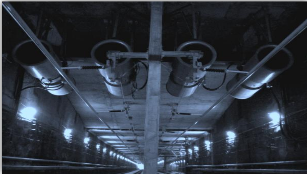
Tunnel Booster Fan
