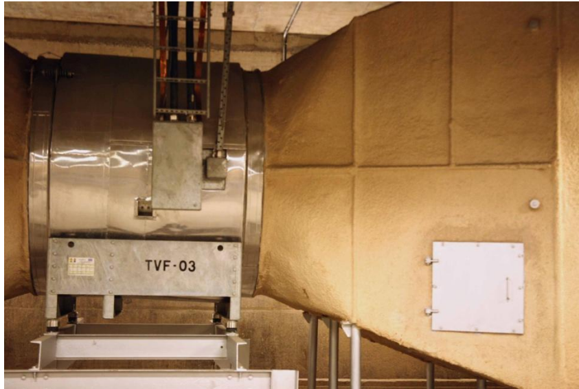
Tunnel Ventilation Fan
