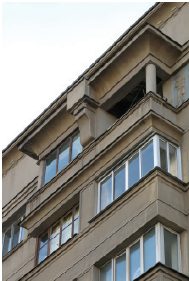
Жилой дом на Садовом кольце в Москве. Архитектор И.А.Голосов. 1934 год. Фото автора
