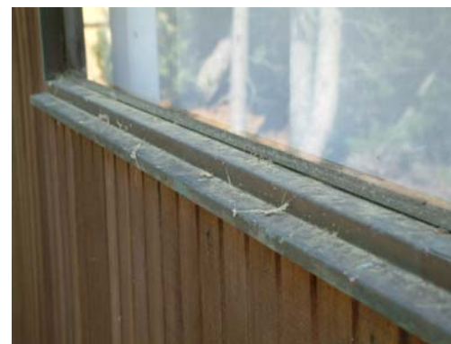
Åt norr är fönstren placerade i liv med fasaden i smäckra ramar.
