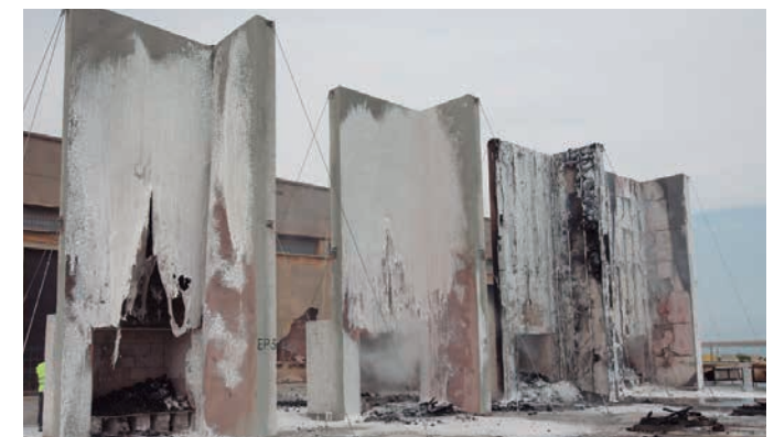
Aspecto después del Ensayo
