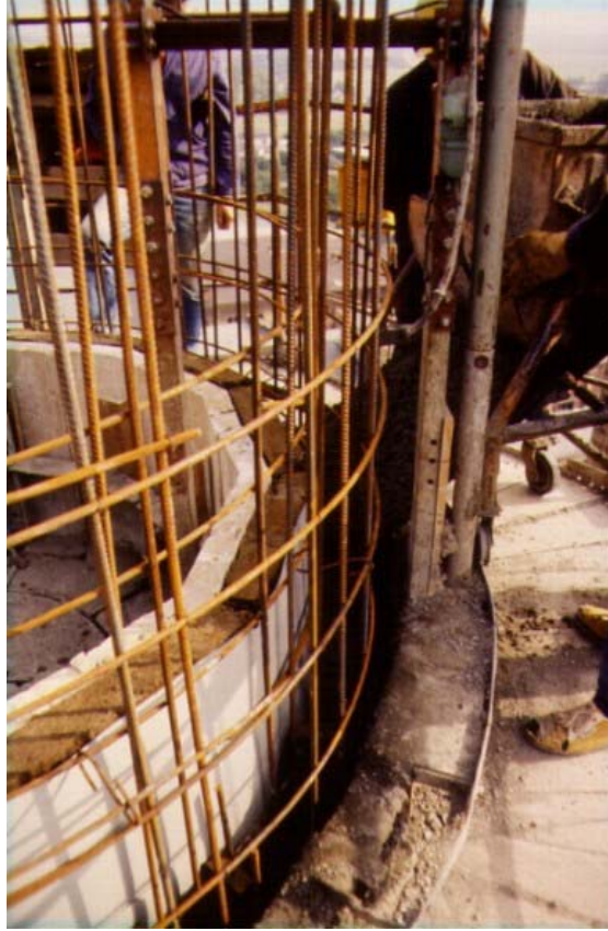
Futterelement aus Wasserglasbeton in einem Säureschornstein
