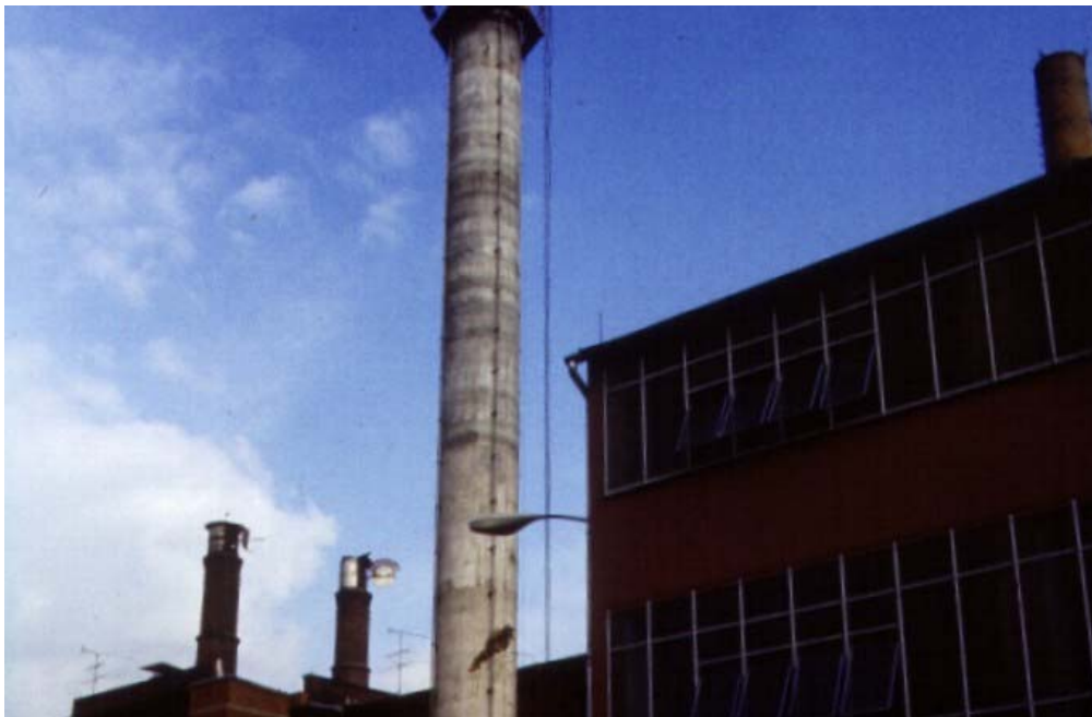
Schornstein nach Inbetriebnahme
