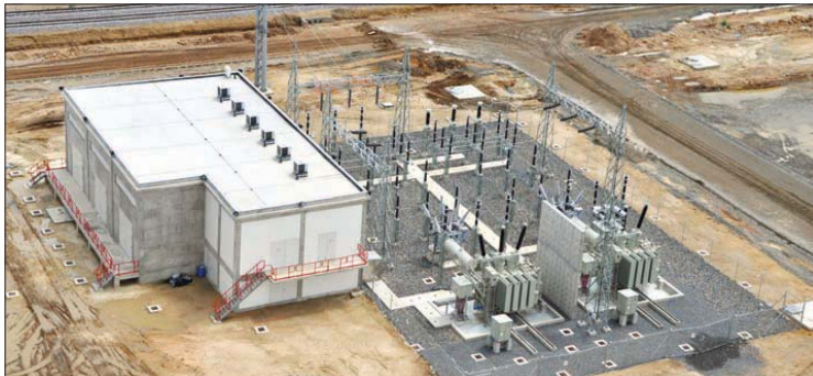
Die Transformatoren auf dem Werksgelände der Ohorongo-Zementfabrik. • Fotos: NamPower
