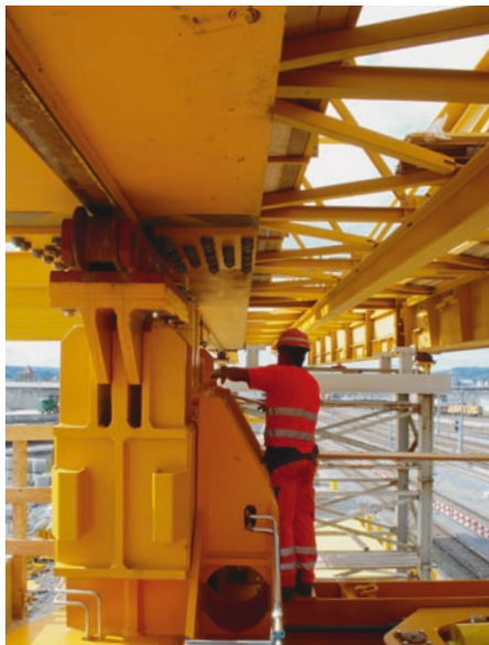
Auf Rollen fährt das Vorschubgerüst zum ersten Pfeiler, während hinten weiter angebaut wird.
