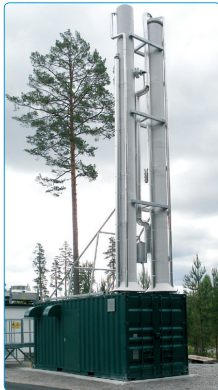
Katrienholmi reoveepuhastusjaamas asuv vesipesul põhinev biogaasi puhastusseade.
