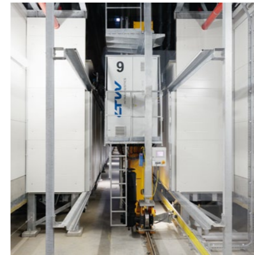
Beim bisher größten einschlägigen Projekt kommen rund 2.200 LTW-Kommissioniertore in 14 RBG-Fahrgassen zum Einsatz.
