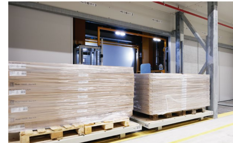
Die Kommissioniertore werden vom Regalbediengerät geöffnet und geschlossen. Im Regal sind keine separaten Antriebe notwendig, was die LTW-Lösung wartungsarm und wirtschaftlich macht.
