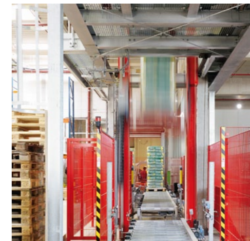
Die automatische Förderstrecke für Vollpaletten umfasst drei Vertikalförderer, zwei Verschiebewagen und Schwerkraftrollenbahnen.
