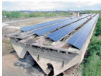
Jetzt muss nur noch die Sonne scheinen: 1621 Solarmodule erzeugen damit bis zu 320 000 kWh Strom pro Jahr. Foto: abakus solar
