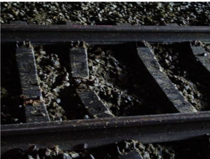
Abbildung 8: Gebrochene Schwelle ca. 6 m nach Auftreffen auf die Schafherde
