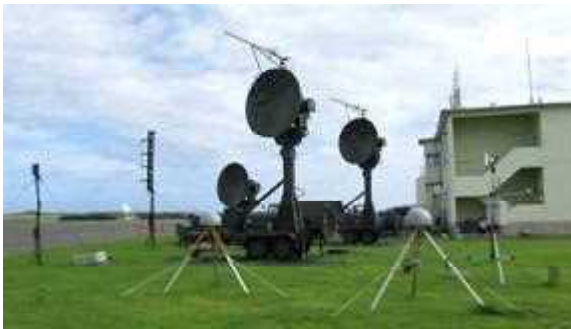
地上装置（屋外機器）
