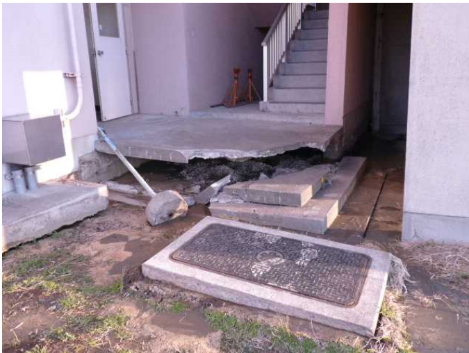
庁舎（試験管理棟）非常口において地盤沈下により損傷
