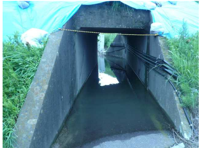
火薬庫土堤トンネルは、地盤沈下により水捌け悪化 また、土堤そのものが規定の形状維持できない状態 にある
