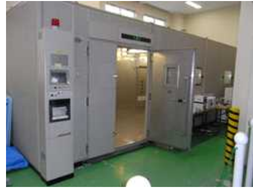
恒温恒湿室（目黒地区）
