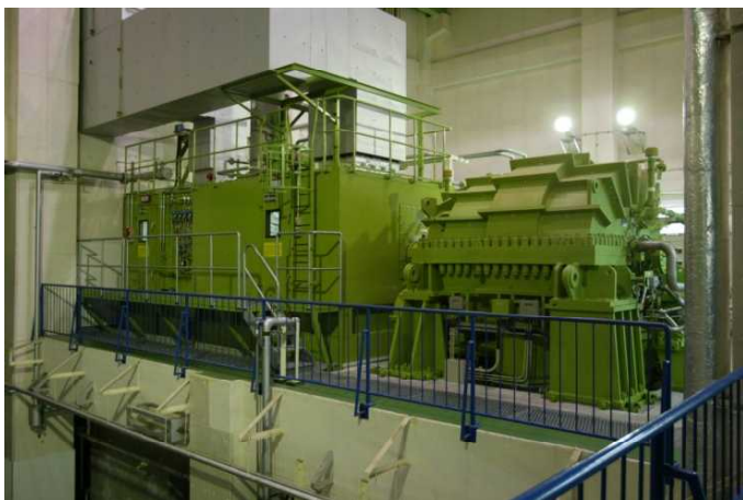
中圧空気源装置のガスタービン及び空気圧縮機
