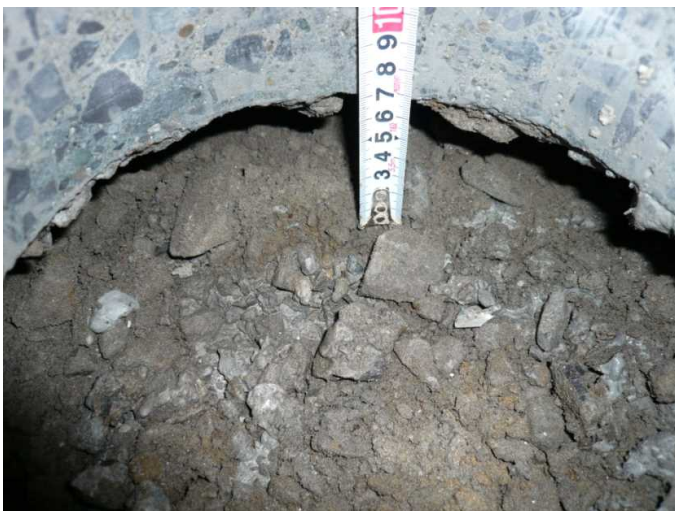
施設の床をコア抜き調査し、大半の試験施設の床下が 空隙であることを確認
