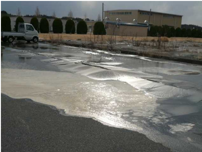
構内道路の液状化現象
