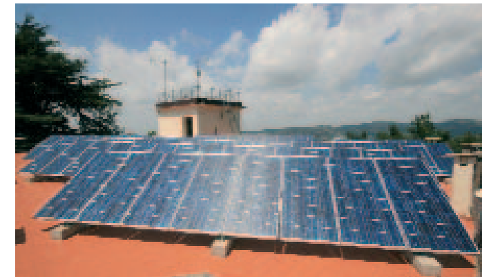
Impianto fotovoltaico della sede del Parco. Foto Roberto Sinibaldi
