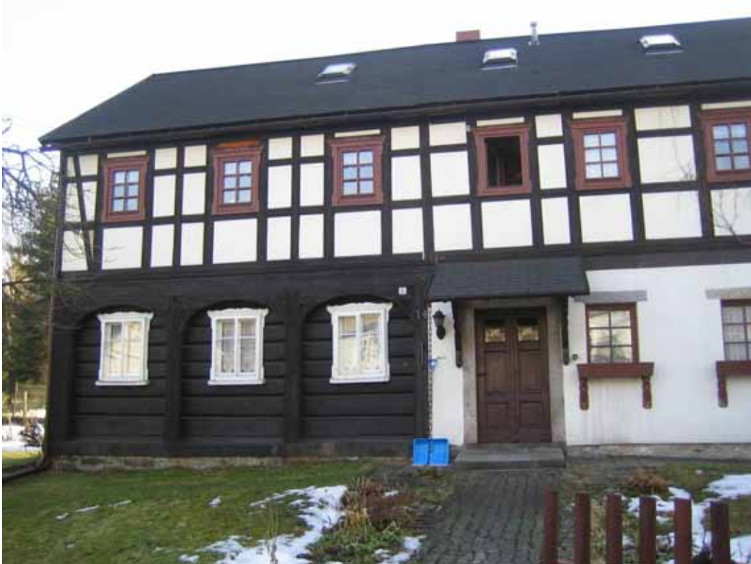
Wehrsdorf, Gebäude mit offenporiger Öllasur sehr gut renoviert, zwei kleine Gefache zeigen Mängel (Putzproblem).
