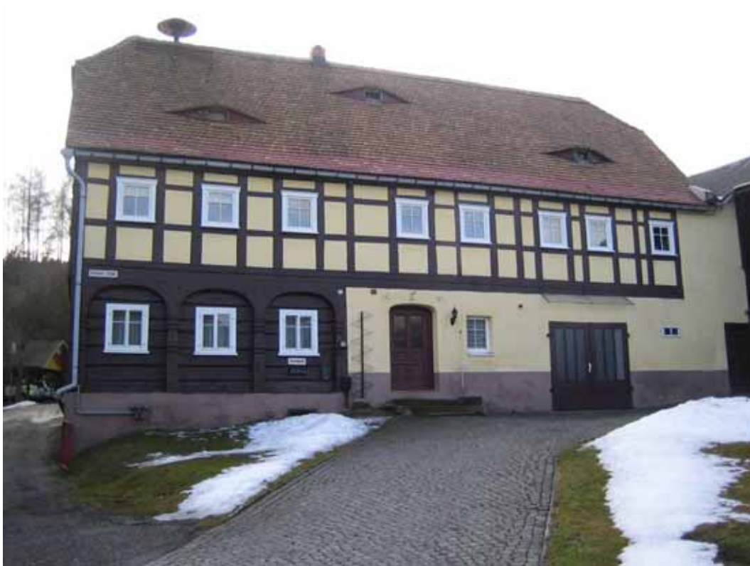
Ringenhain, Umgebinde restauriert. Holzanstrich leider nicht mit Lasur sondern mit schichtbildendem Material. Damit sind Probleme voraus zu sehen.
