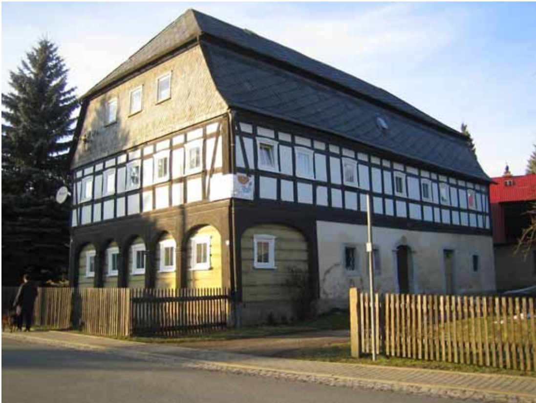
Wehrsdorf, Umgebäudehaus, vor 30 Jahren restauriert, bisher ohne weitere Pflege, sollte aber jetzt einen Holzschutz erhalten.
