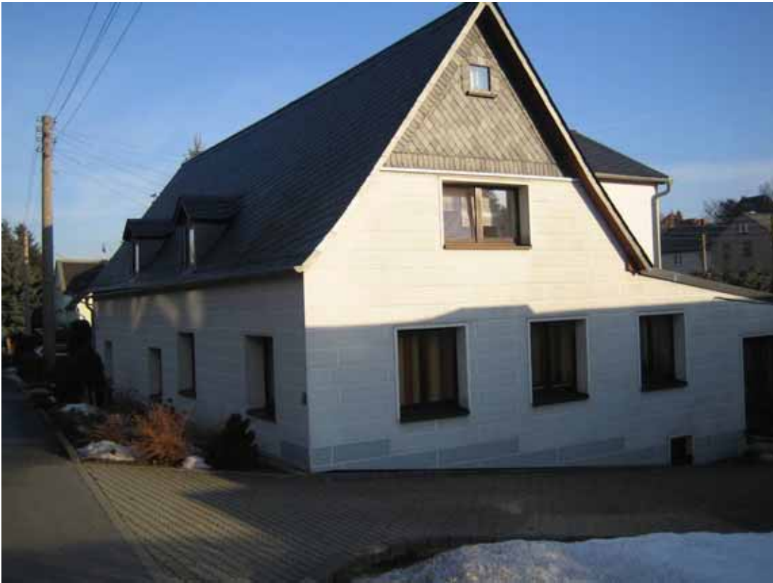
Wehrsdorf, verkleidetes Umgebäudehaus, hier sind große Schäden vorprogrammiert.
