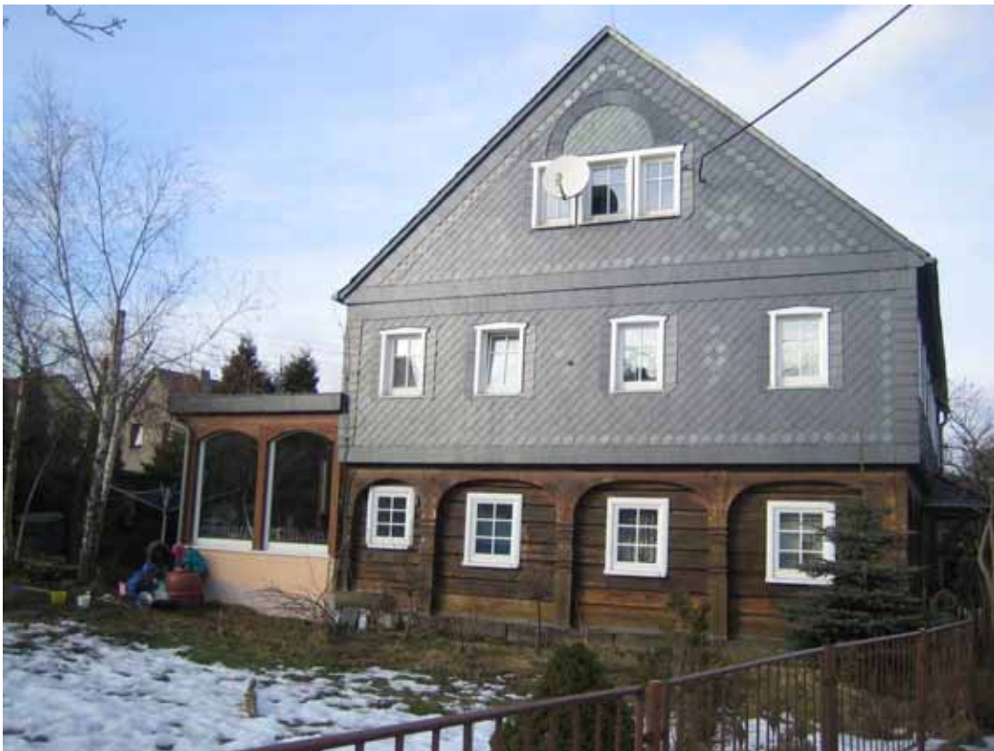
Steinigwolmsdorf, Gebäude vor wenigen Jahren mit Dickschichtlasur behandelt, zeigt wieder dringenden Sanierungsbedarf.
