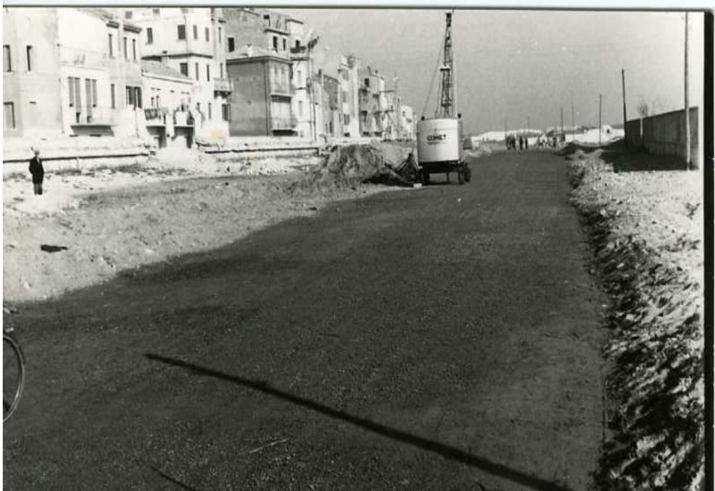
44 – Sottomarina. Costruzione della strada a S. Felice ai piedi del “murazzo”, s.d. (foto Biblioteca Civica Sabbadino)
