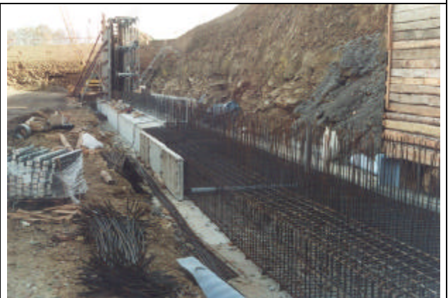
Fundamentierungsarbeiten am Ostende der südlichen Fundamentgrube des Einschnittes. Im Hintergrund erste Schalungsarbeiten für die Tunnelröhre (Blick nach Osten).
