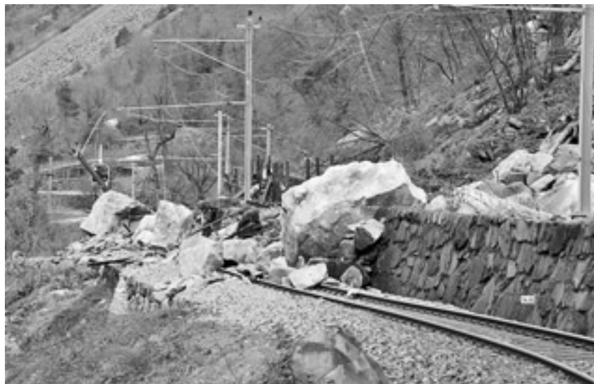
Die Konsequenzen des Steinschlages vom Sonntag (Bild) sind grösser als zunächst angenommen. Die Bernina-Strecke wird frühestens im März wieder betriebsbereit sein. Foto: Christian Ticar
