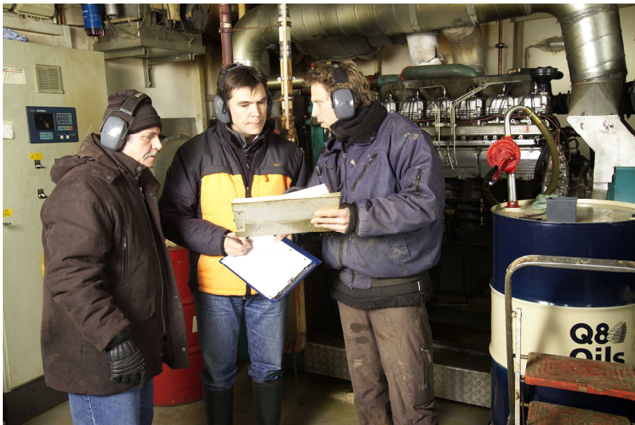
Einsicht in BHKW-Aufzeichnungen einer Biogasanlage
