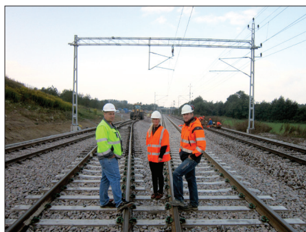
Berne Svensson från Trafikverket, inspekterar mötesspåret tillsammans med Madeleine Bojsen och Staffan Nilsson från BCA.
