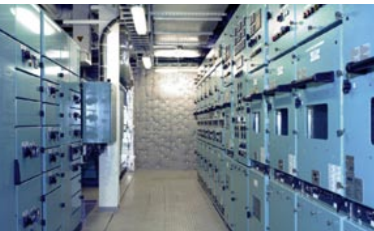
Die Schaltanlage der „PRIDE OF AMERICA“ ist ausgerüstet mit Technik von SAM Electronics
