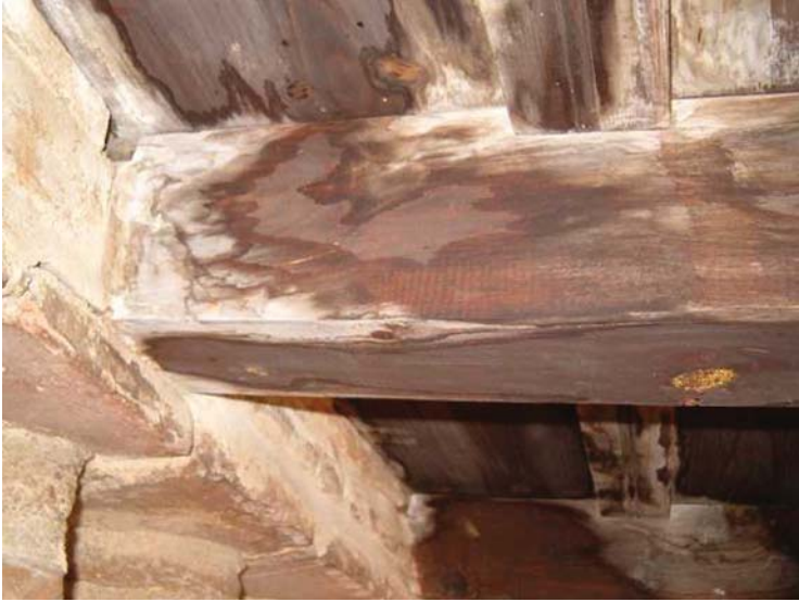
8. La humedad por filtraciones es la emergencia que con mayor frecuencia se constata en nuestros museos. Si su acción es continua, provocará daños irreversibles (Foto: Archivo particular C.R.G.).
