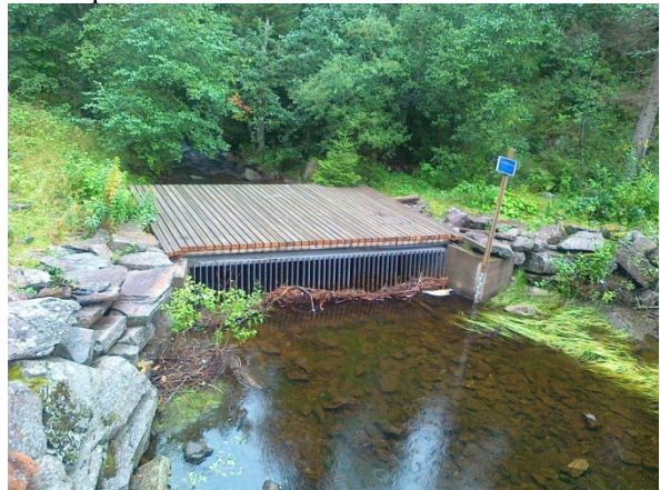
Minstevannføringen som slippes til Fjellhammerelva kommer opp på bunnen av denne kulpen rett nedenfor overløpet. I nedkant av kulpen, bak gitteret, er det en v-notch for å måle vannføring.
