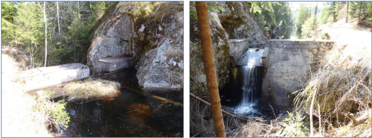
Figur 172. Dammen på Langvann, sett ovenfra og nedenfra. Dammen er umulig å passere for fisk. På det venstre bildet ser man at det er ganske bratt nedover. Foto: VAV.
