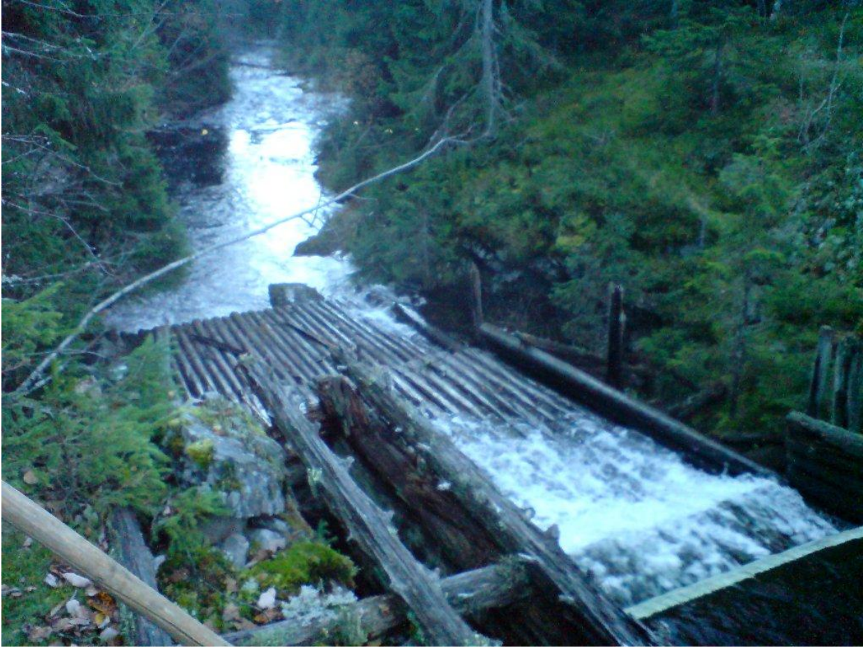
Figur 134. I utløpet av Myrtjern er det en ødelagt tømmerkistedam med lederenne for tømmer «skottbru» som de ofte kalles. Foto: VAV.
