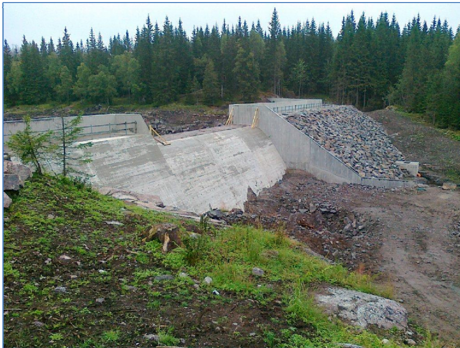
Figur 34. Den nye dammen som bygges i utløpet av Svarten sett nedenfra ved flomoverløpet. Fra august 2012. Foto: Dag Berge.
