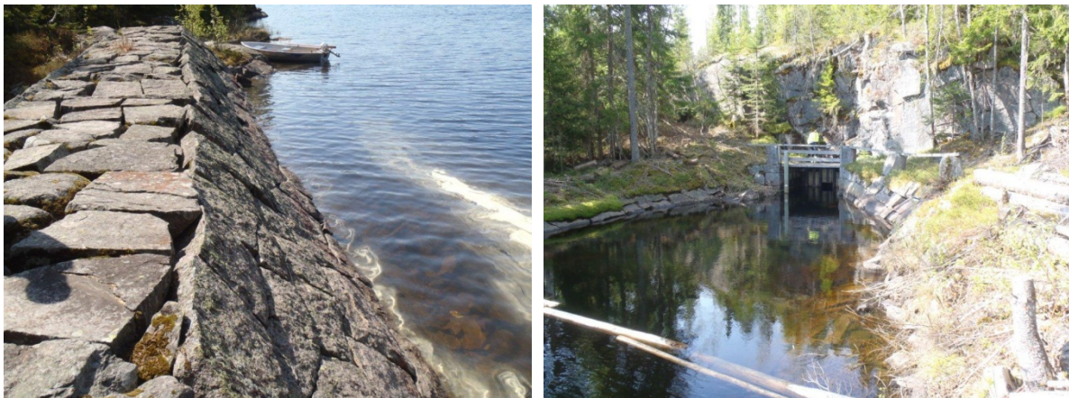
Figur 121. Oppdemming av det naturlige utløpet mot Langevann og Nitelva (venstre panel) og tunnelinntaket ned mot Helgeren. Foto: VAV.
