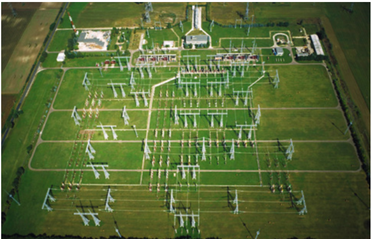
AZ ALBERTIRSAI 750/400 KV-OS ALÁLLOMÁS - MADÁRTÁVLATBÓL
