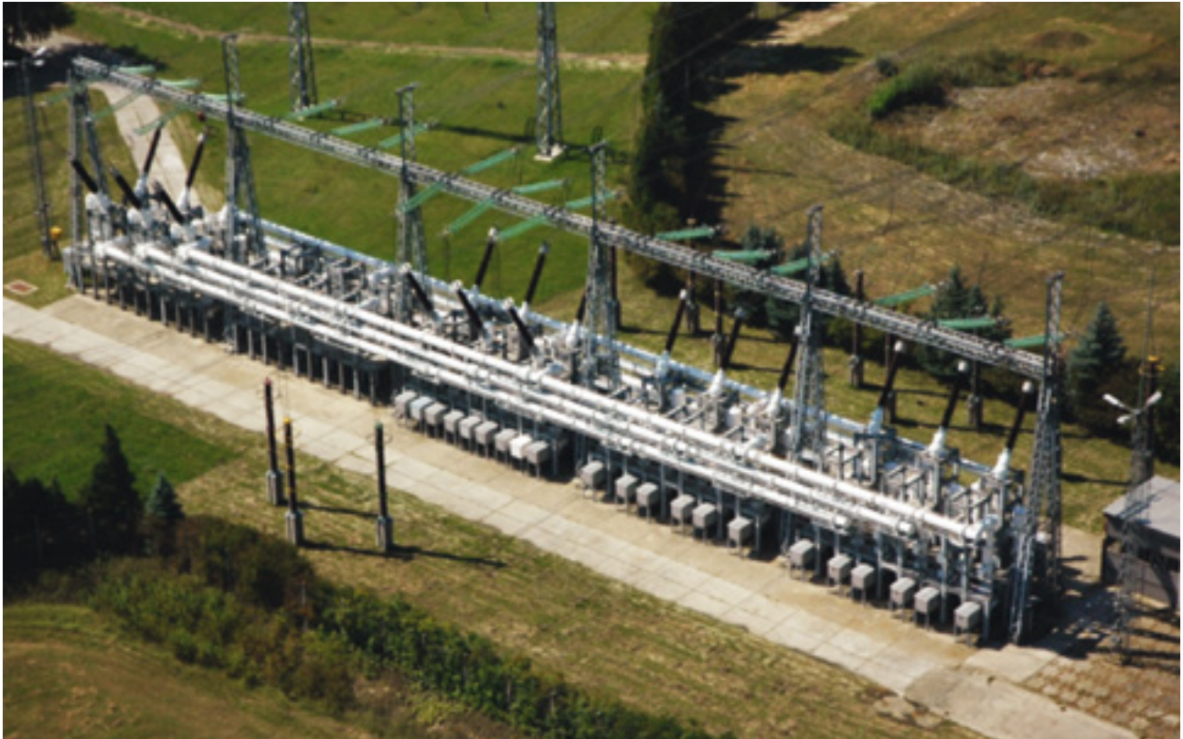
A KÉNHEXAFLUORID-GÁZ SZIGETELÉSŰ, FÉMTOKOZOTT 400 KV-OS KAPCSOLÓBERENDEZÉS
