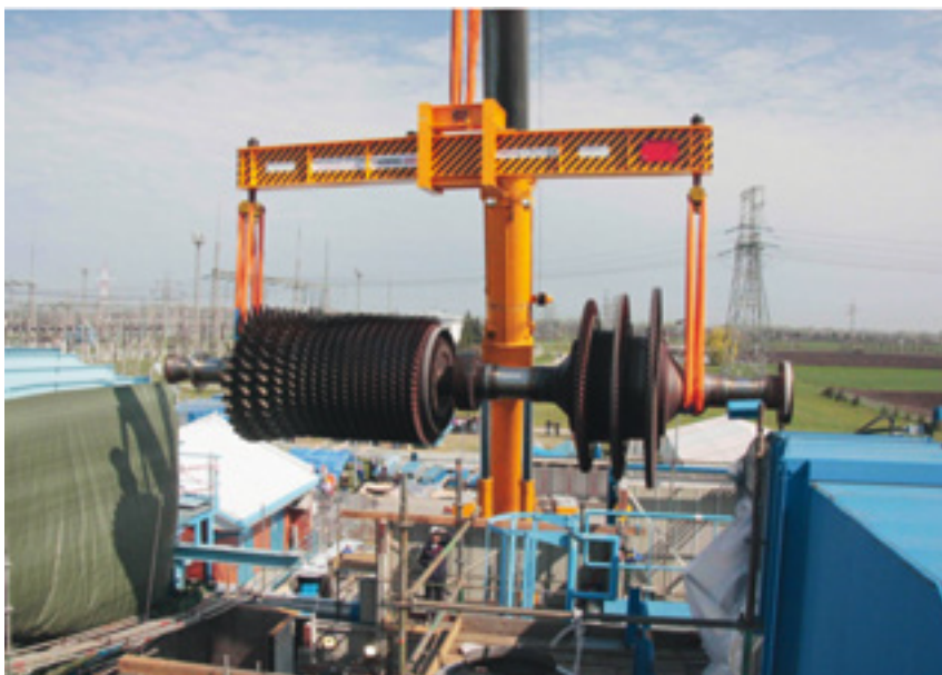
6. KÉP: A SAJÓSZÖGEDI GÁZTURBINÁS ERŐMŰ KARBANTARTÁSA - TURBINA ÉS KOMPRESSZOR FORGÓRÉSZ KIEMELÉSE
