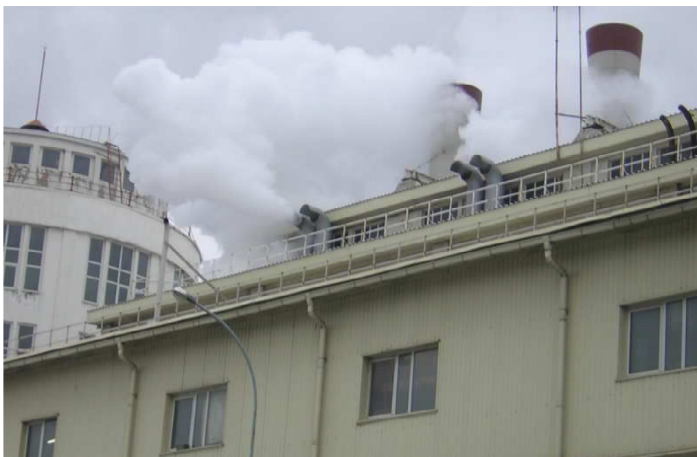
Рис.3. Испытания глушителей шума выброса пара конструкции МЭИ, установленных на выхлопных трубопроводах после ГПК котлов ст.№№1, 2. ТЭЦ-7 ОАО «Мосэнерго»
