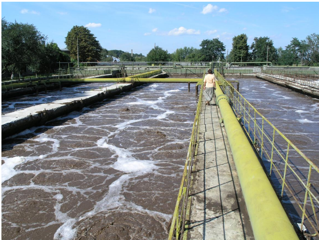
Очисні споруди ЛМКП «Львівводоканал»
