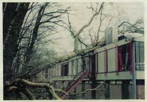
Test van de dakconstructie van het clubhuis na een hevige storm in 1974.
