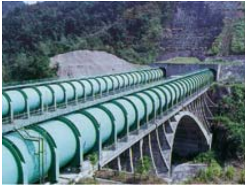
照片 6 導水鋼管
