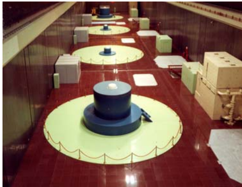
◀ 照片 11 明潭抽蓄發電廠發電機組
