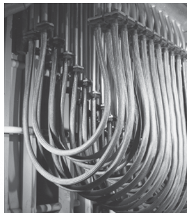
Bild 3.1.8 Metallschlauchleitungen in einer Etagenpresse
