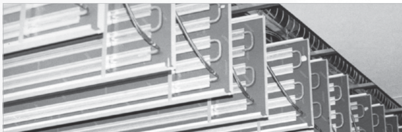
Bild 3.4.10 Geöffnete Kühldecke mit flexiblen Anschlussleitungen
