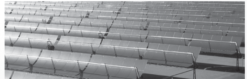
Bild 3.3.1 Solarfeld eines Parabolrinnenkraftwerks
