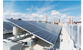
屋上に設置された太陽光発電パネル。発電容量は40kWで、状況は1階ホールのモニターで確認できる
