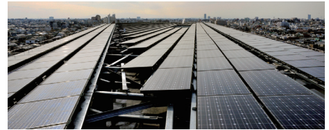
屋上設置の太陽光パネル
