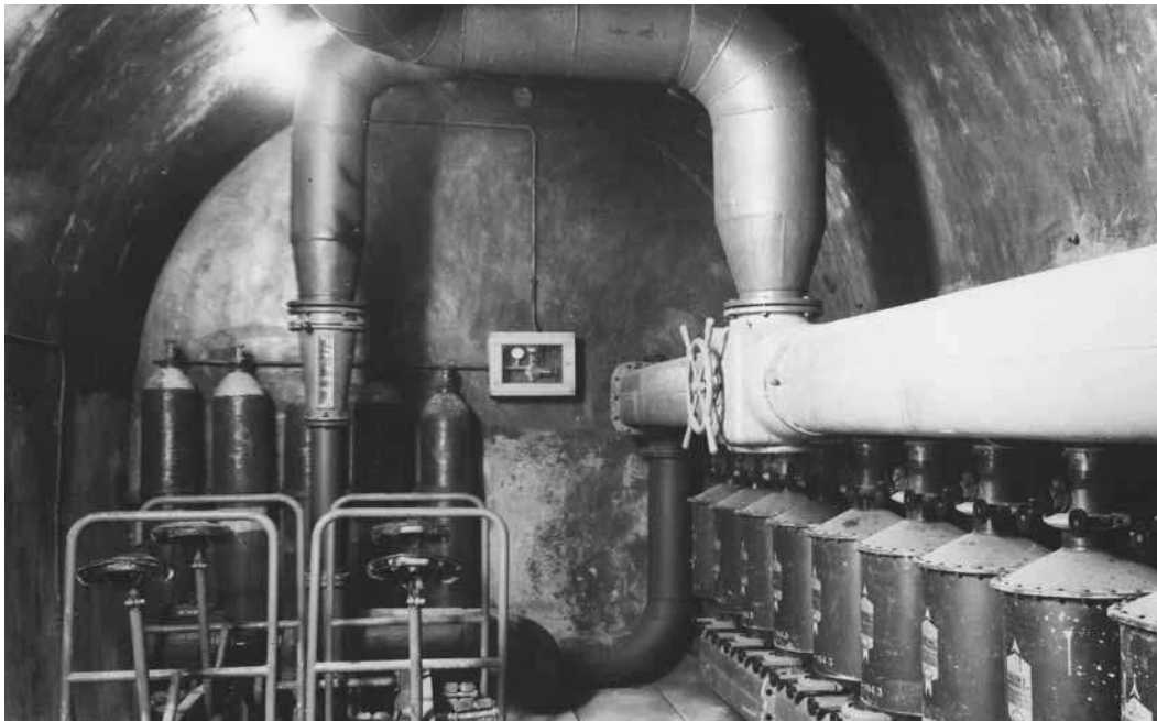
Impianti di ventilazione e filtrazione nel rifugio "Garbagni".
