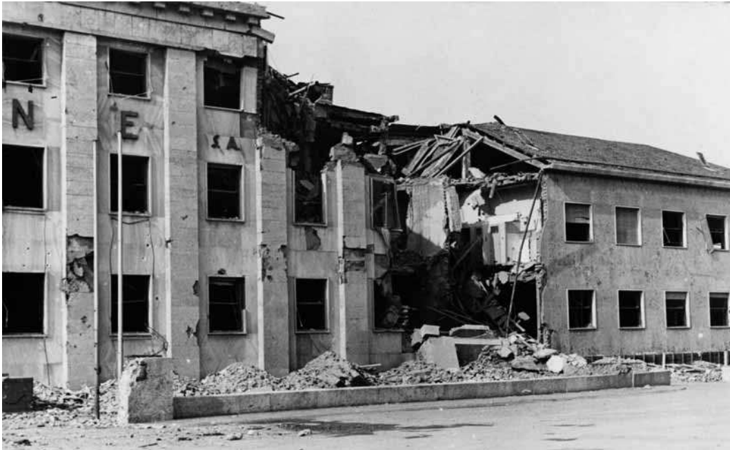
Il danno provocato dalla bomba che colpisce il Palazzo della Direzione durante il bombardamento del 6 luglio 1944.
