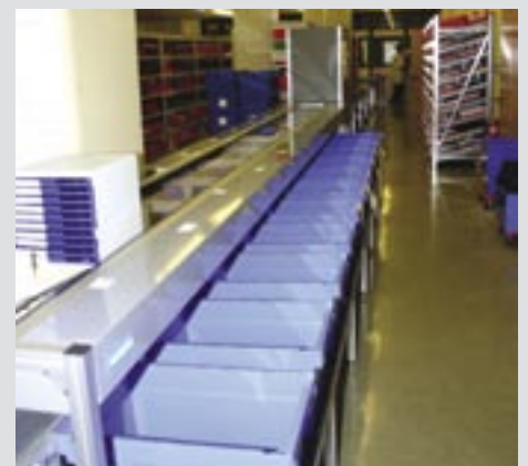
Auf dem Förderband der neuen Apothekenstraße im Klinikum Ingolstadt laufen die Medikamente zielsicher in den richtigen Versandkorb
