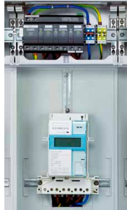
Installation im Verteiler Quelle: PHOENIX CONTACT
