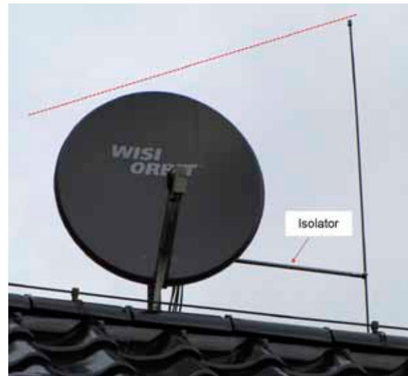
Bild 11: Gebäude mit Blitzschutzanlage
