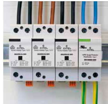
Installation im Verteiler (V Verdrahtung) Quelle: CITEL
