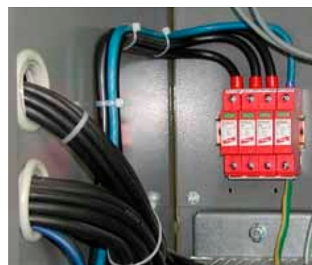
Installation im Verteiler Quelle: DEHN
