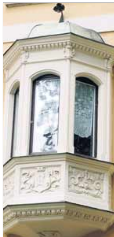
Dieser Erker in der „Belle Etage“ (1. Stock) stammt noch aus der Bauzeit.
