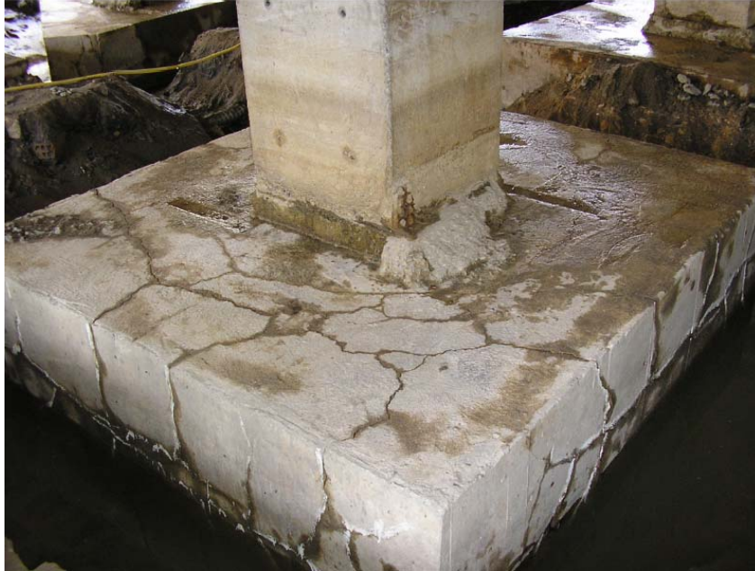
Figura 5.1: Bloco de Fundação com padrão de fissuração típico de reação álcali-agregado (PECCHIO apud MUNHOZ, 2007)
