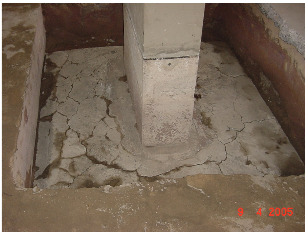
Figura VII.6.19 – Fotografia de um bloco de fundação de um edifício na Cidade do Recife afetado pela RAA
