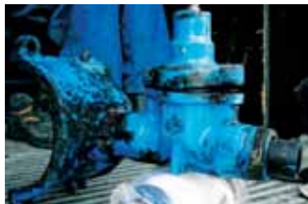
26 Syövyttävä talousvesi ja putkitöiden heikko laatu ovat merkittävä uhka vesijohtoverkoston kestävyydelle.
