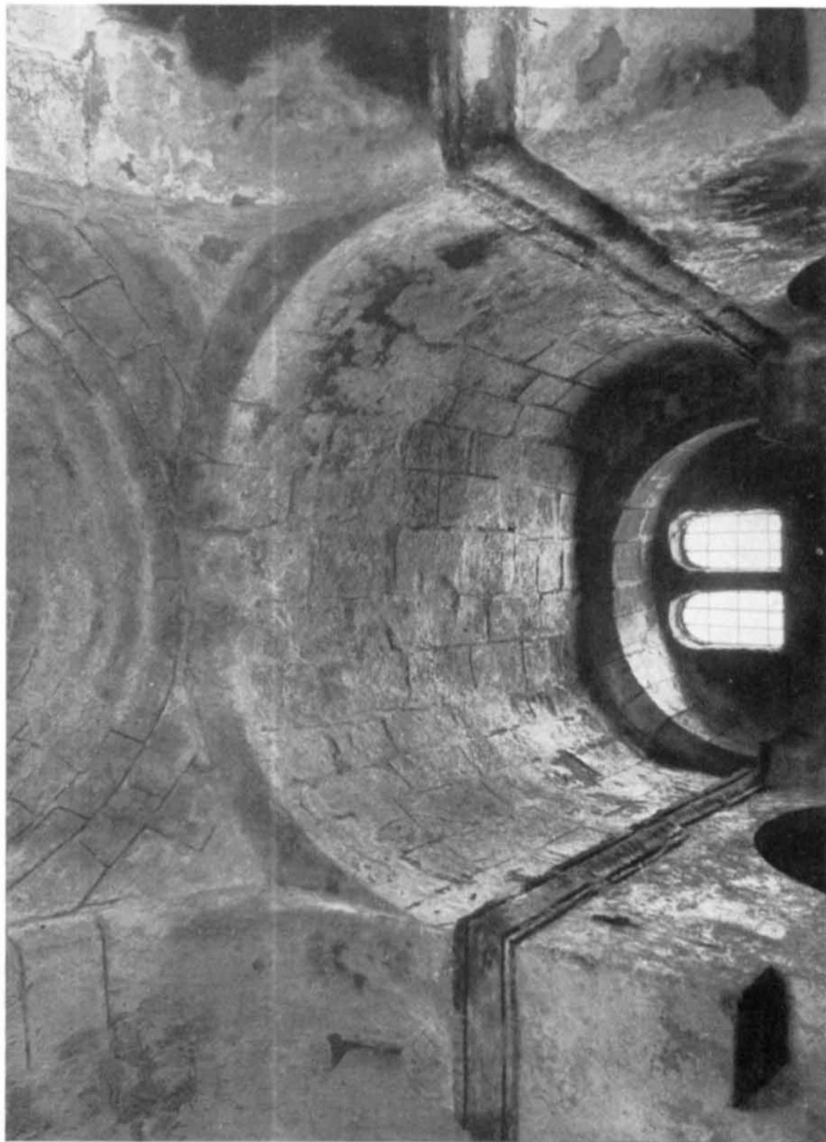
CABRAS — CHIESA DI S. GIOVANNI DI SINIS: VOLTA DEL BRACCIO NORD DEL TRANSETTO
