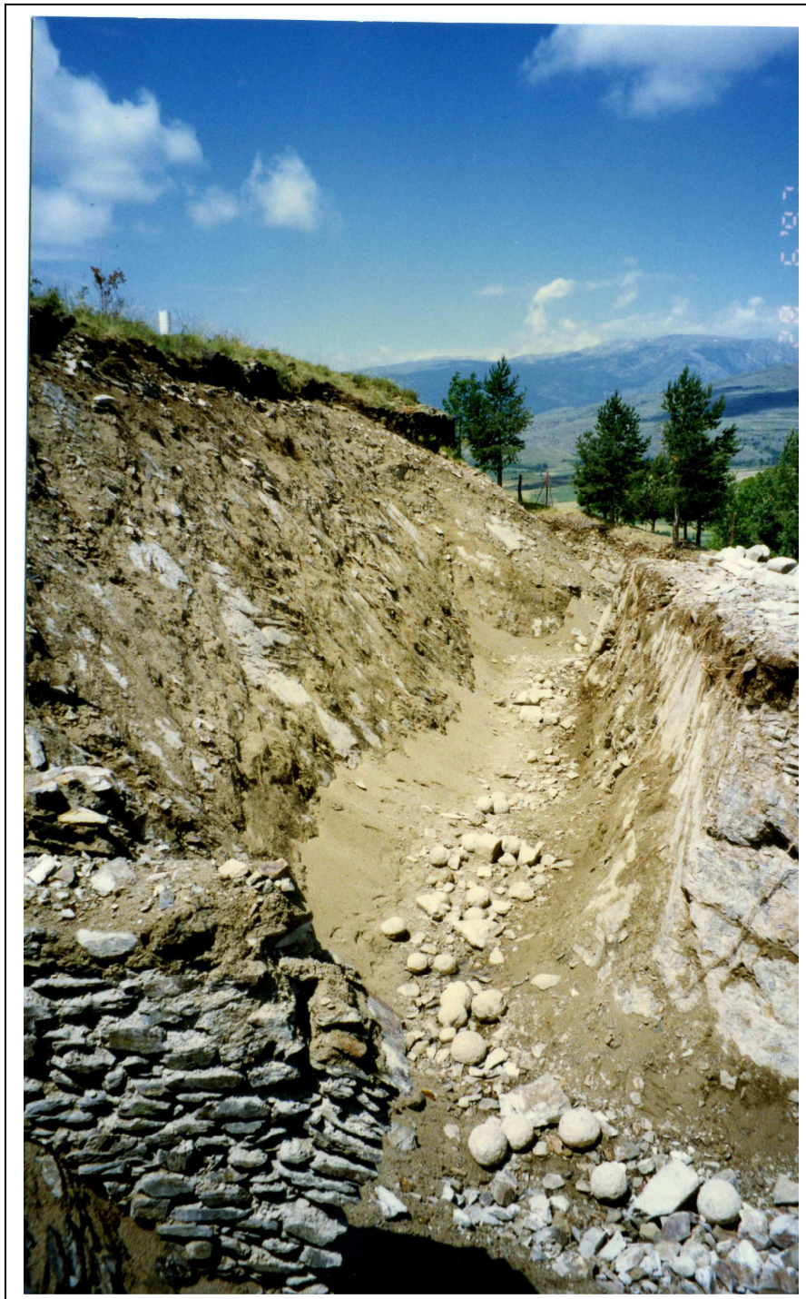
Figura 6: Tasques de neteja al fossat nord del castell. En derruir la fortalesa, aquest element fou colgat amb la runa dels paraments i els murs, amb la voluntat d'inutilitzar la fortalesa de forma definitiva. En aquesta imatge es poden observar alguns dels nombrosos projectils de pedra, juntament amb altres materials, que s'hi van abocar.
