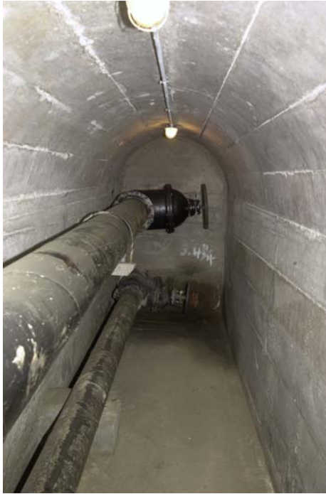
Photo 3. Galerie dans la dige du lac d'Icogne et départ de la conduite forcée en DN 300 pour l'irrigation
