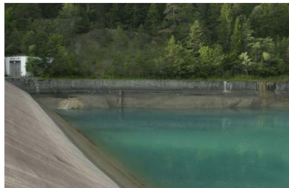
Photo 6. Bassin de compensation et centrale enterrée de Croix
