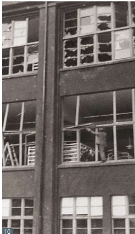
Abb. 10 Rottweil Neckartal 171, Spulerei, ehemalige Rottweiler Pulverfabrik Zerschlagene Fenster durch eine Explosion im Jahr 1942.
