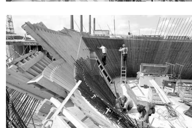
Schalungs- und Bewehrungsarbeiten an den trichterförmigen Kegelelementen im Obergeschoss, Sommer 2003. Die Bewehrungsdichte und die Neigung der Wände erforderten den Einsatz eines Sonderbetons
