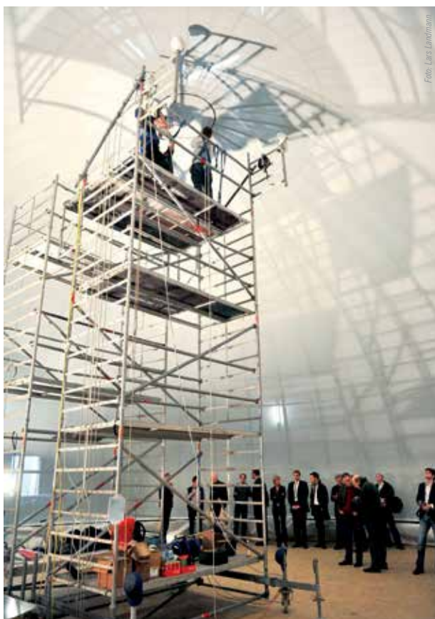
Sanierung des Planetariums im Frühjahr 2010 Einsetzen des letzten Elements der neuen Projektionsfläche in der Innenkuppel.
