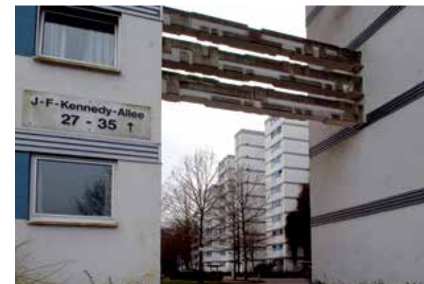
Zustand der „Burg“, 2008. Insbesondere im Wohnungsbau beschränkte sich die Architektur auf wenige gestalterische Elemente, was im besten Fall zu ruhigen Fassaden mit einem begrenzten Farbspektrum führte, häufig aber zulasten der Ästhetik ging.
