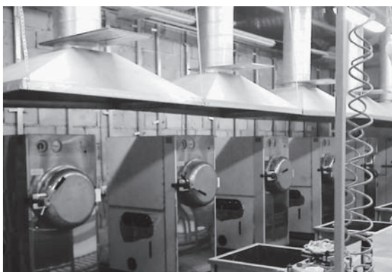
Рис.3. Вытяжная вентиляция в модельном цехе ООО «Завод АКС»
