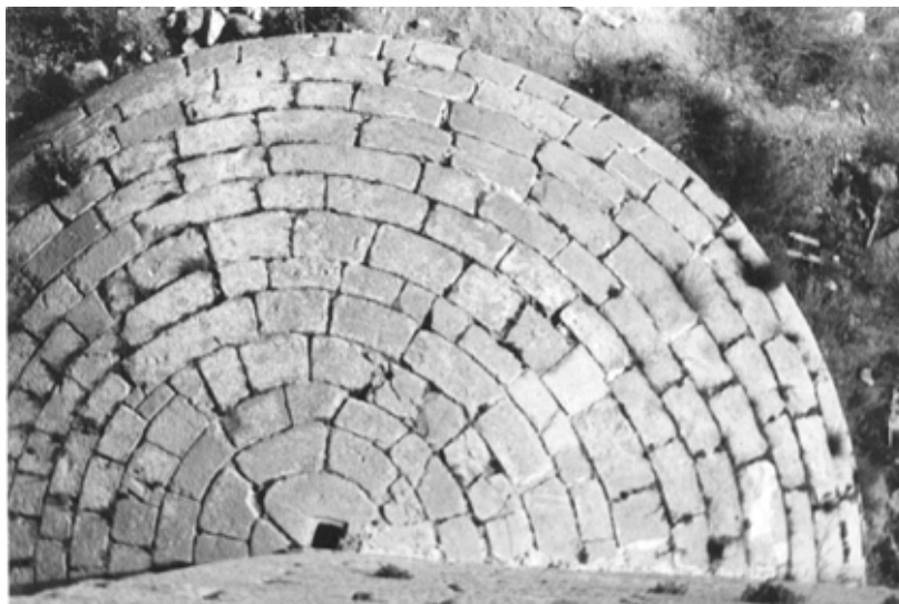
Foto 5: Orpesa, Castelló. Torre del Rei. Caponera del NO vista desde lo alto de la torre en la cual puede observarse perfectamente la forma de construcción: la trampilla de ventilación de la misma, en su parte más alta, junto al muro de la Torre y los distintos desperfectos motivados por sendos disparos de la artillería francesa del General Souchet en 1811.
