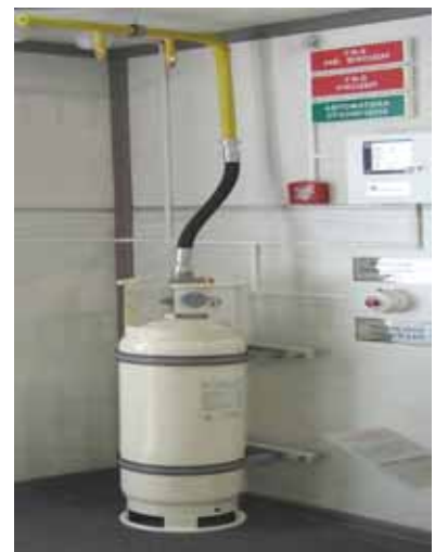
Установка газового пожаротушения ЭЦ-ТМ.П
