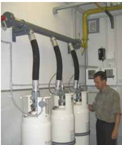
Установка газового пожаротушения в составе ЭЦ-ТМ.П
