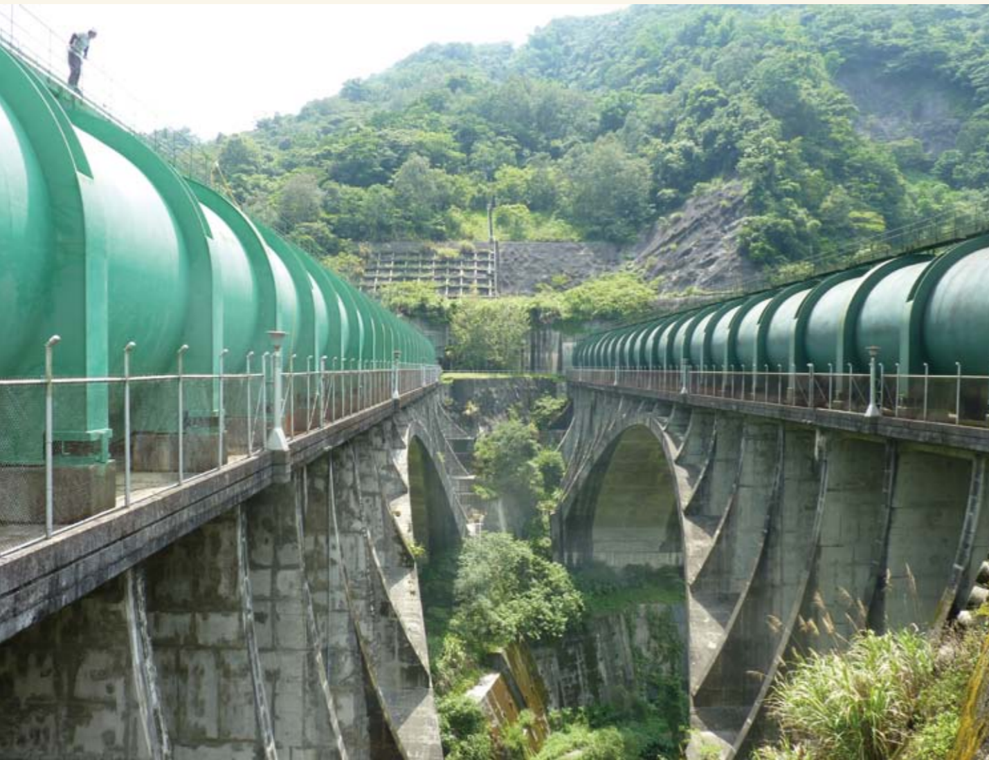
明潭發電廠的過河鋼管。
