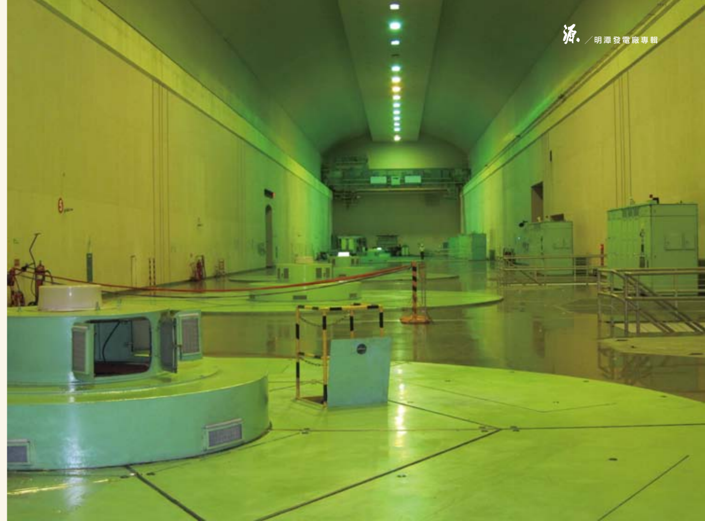
明潭發電廠的地下廠房。
