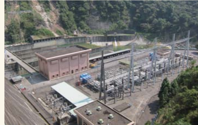
明潭發電廠的開關場。
