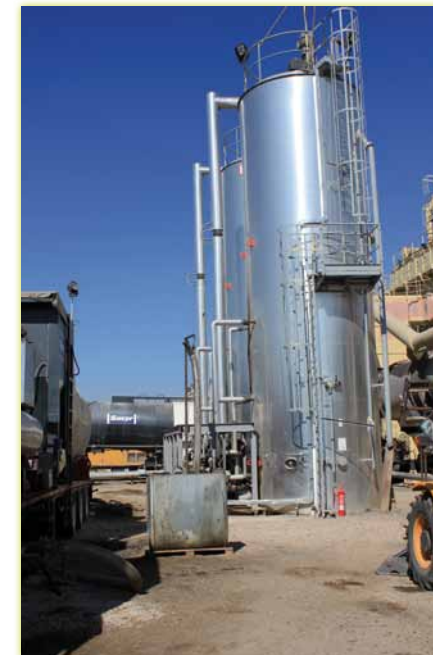
Figura 20. Tanques auxiliares de almacenamiento
